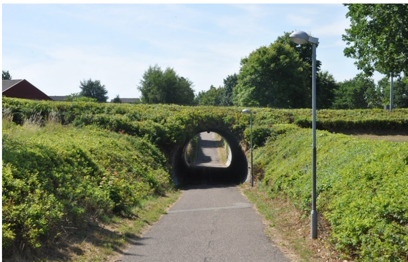
Stitunnel under Frederiksborgvej. Armaturet er af typen Stradalux. Udskiftet i 2018.
