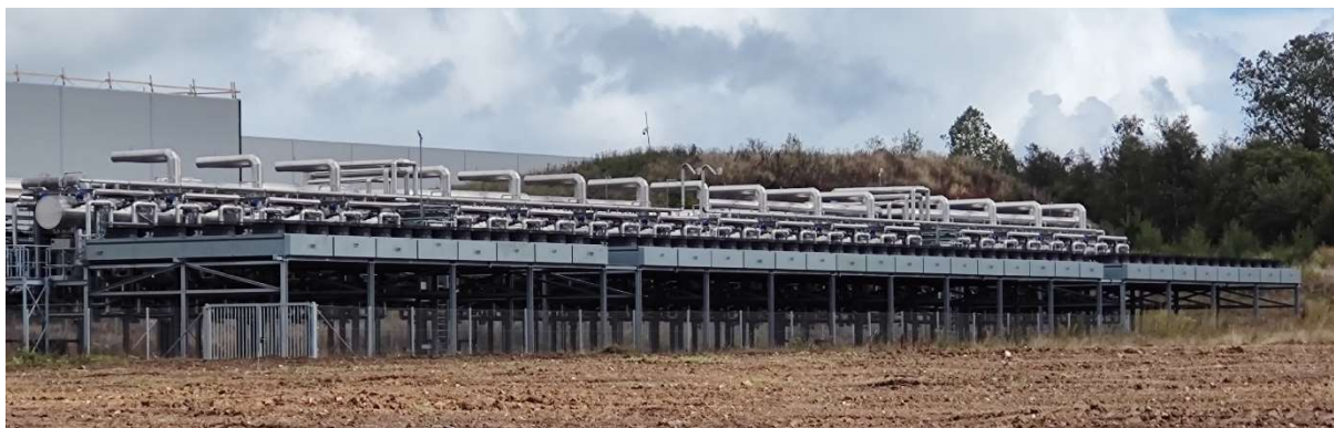
Figur 21 - Kølegården til varmepumpen ved Farum Fjernvarme
