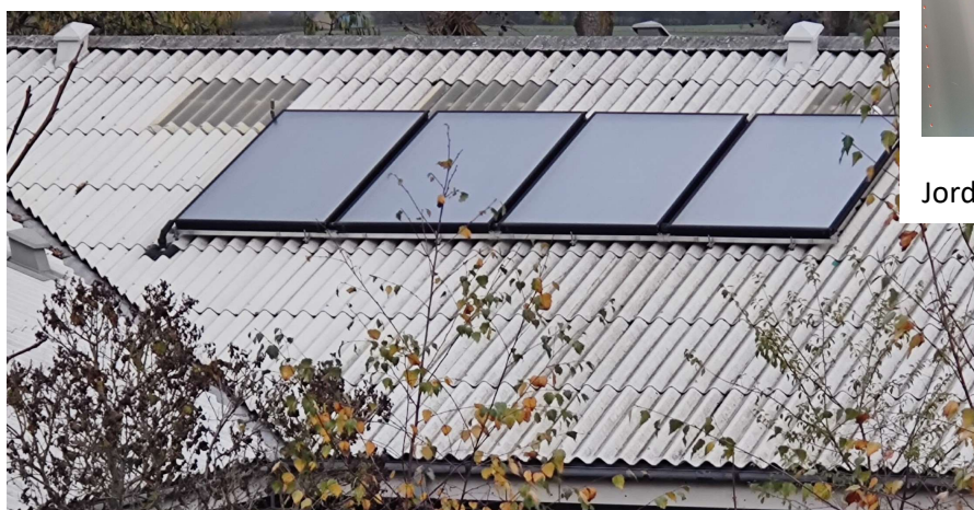
Solvarmeanlæg – Elmedalen 2A
